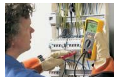
Проверка изоляции в распределительном щите
