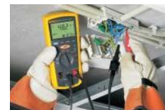
Проверка проводки в небольшой распределительной коробке – все в одной точке
